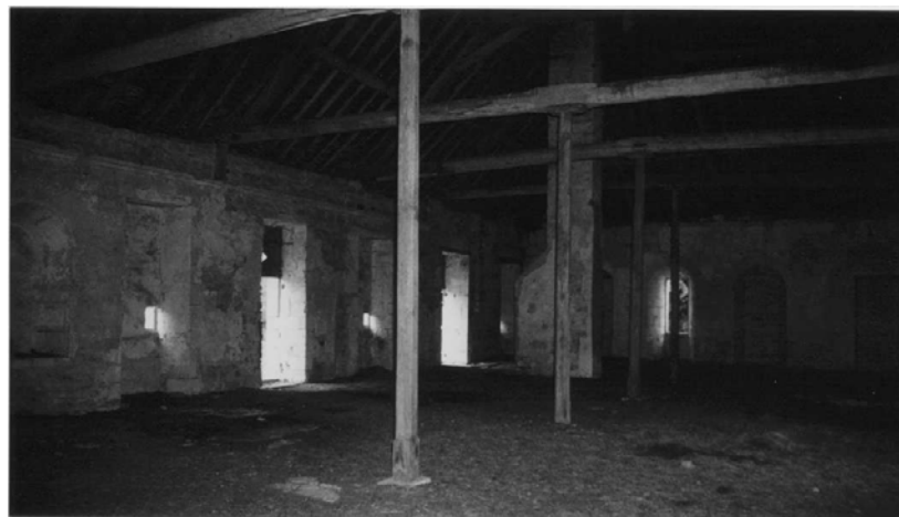
Quincy – Vue générale de l'étage du bâtiment des moines. Les cloisons de l'Epoque moderne ont été détruites au XIXe siècle pour aménager un vaste volume destiné au stockage des céréales de l'exploitation agricole.
