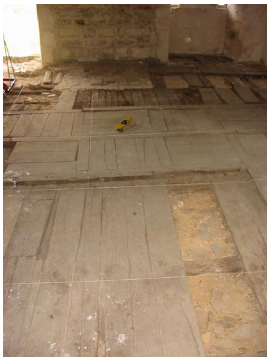
Quincy – Planchers du dortoir des moines. Partiellement conservés dans l ‘angle sud-est du dortoir, ces deux niveaux de plancher en bois conservent le souvenir des aménagements des logis dans le dortoir à l’Epoque moderne.
